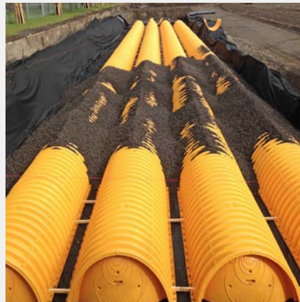
Chambre de rétention (fermée) Parc Claude-Robillard, Montréal
